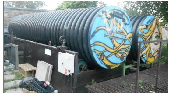
Double composteur électrique de quartier Source : Personnelle - 2014
